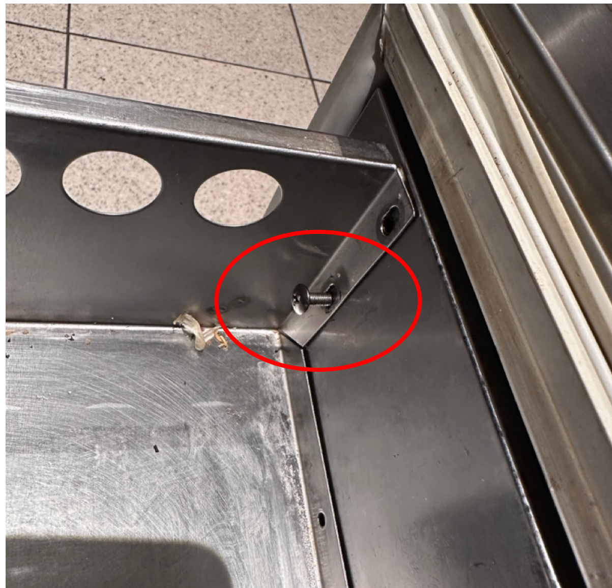
Baut chiller dalam kondisi longgar
