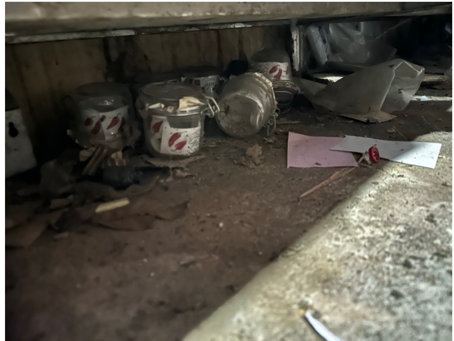
Kolong dry store dalam kondisi sangat kotor
