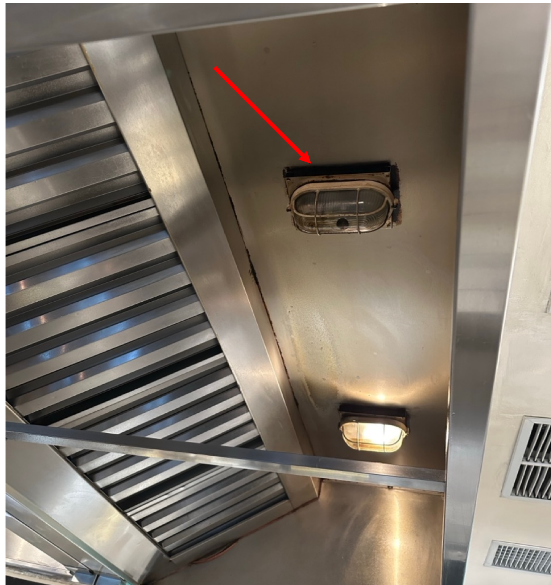
Terdapat lampu di ruang produksi dalam kondisi mati
